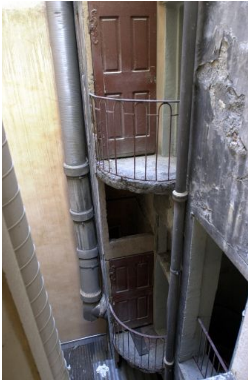
Façade sur cour, détail des passages reliant la cage d'escalier aux lieux d'aisance
