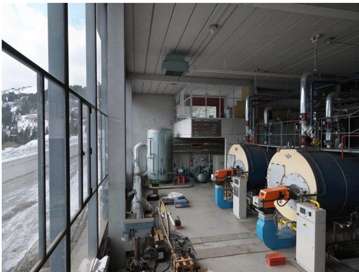
Les chaudières et la baie vitrée sud
