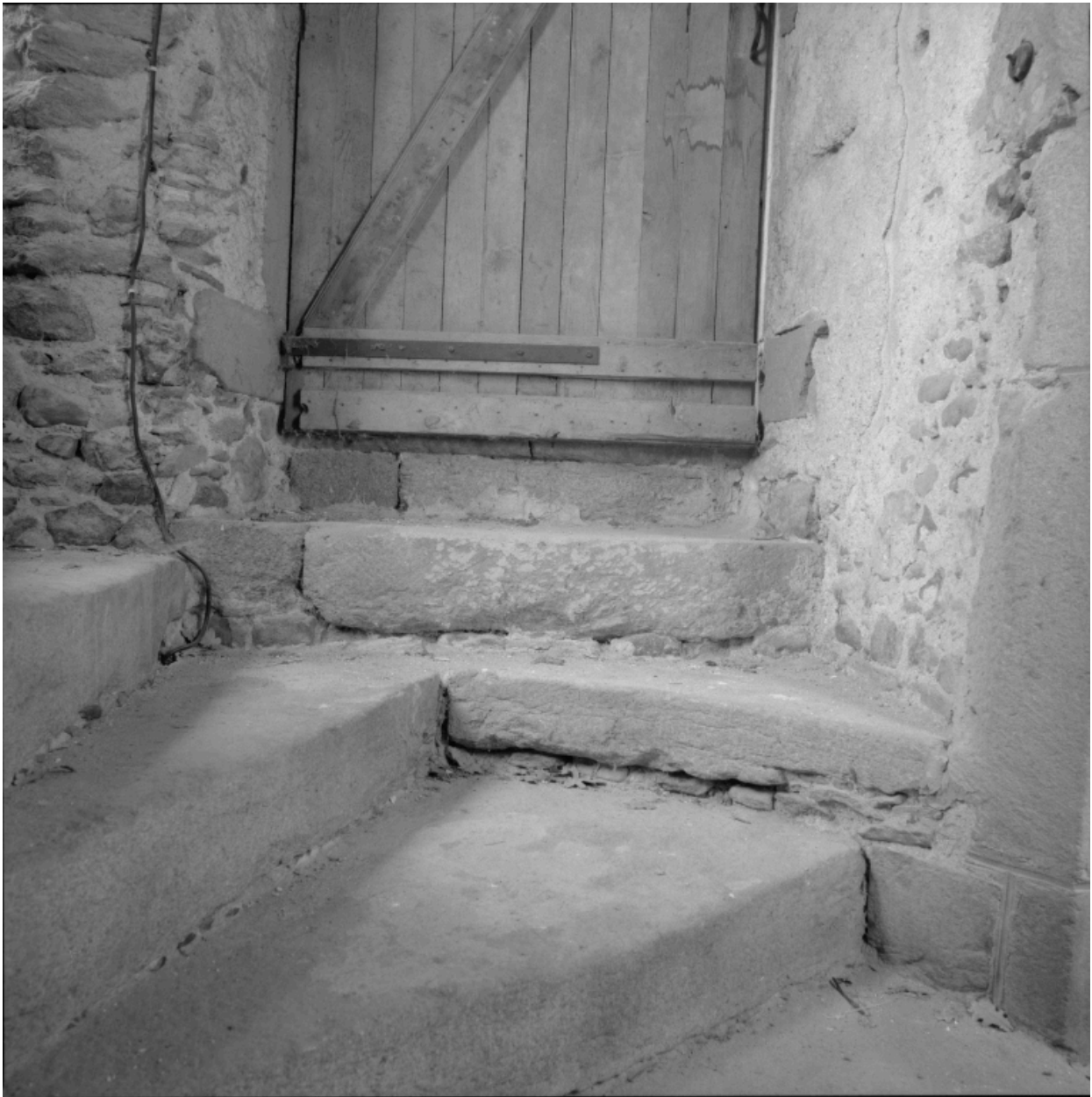
Corps de galerie, rez-de-chaussée, tour d'escalier nord-ouest : vue des marches au niveau de la porte d'accès à la galerie.
