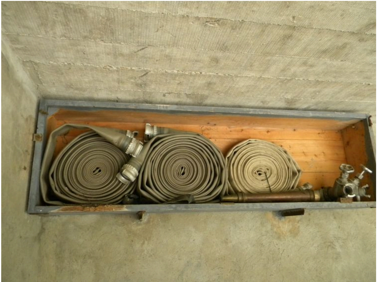
Vue du placard avec le matériel incendie.
