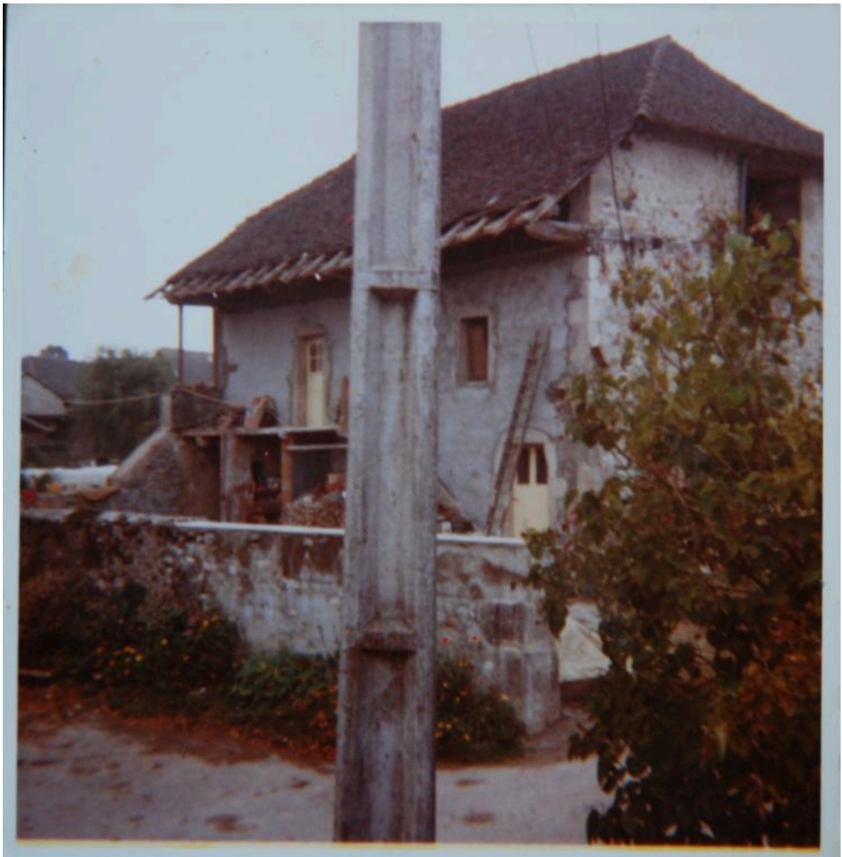
Ferme, puis maison (2016 A6 333, non repérée). Vue depuis le nord-est, en cours de réfection de la toiture (début des années 1980) (collection particulière).
