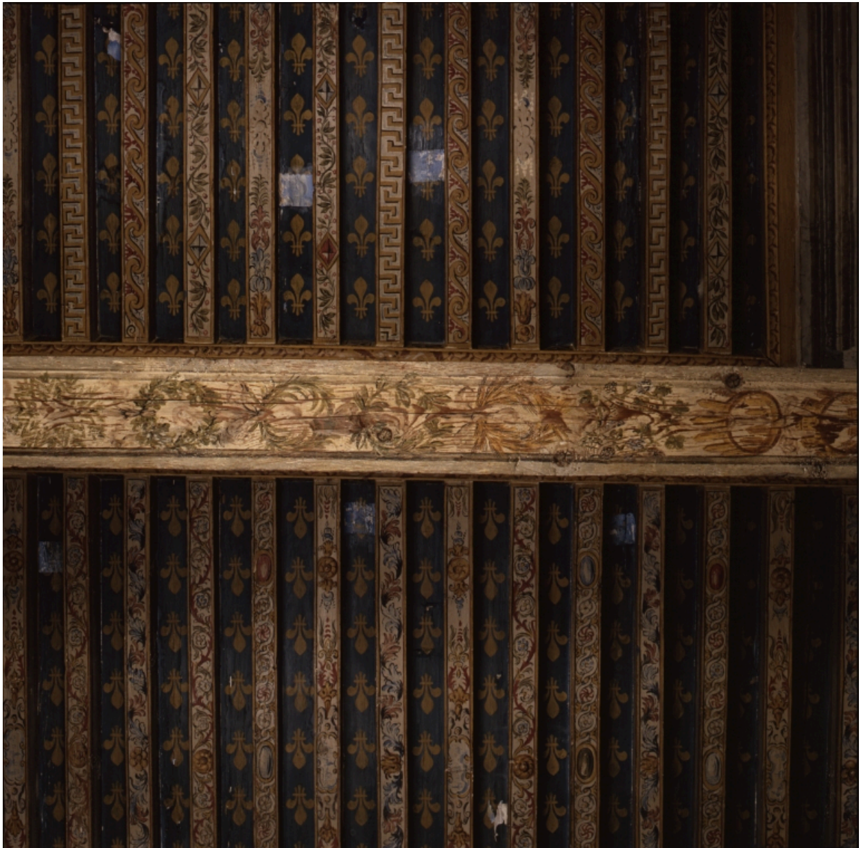
Poutre 5, face inférieure, côté gauche : couronnes.
