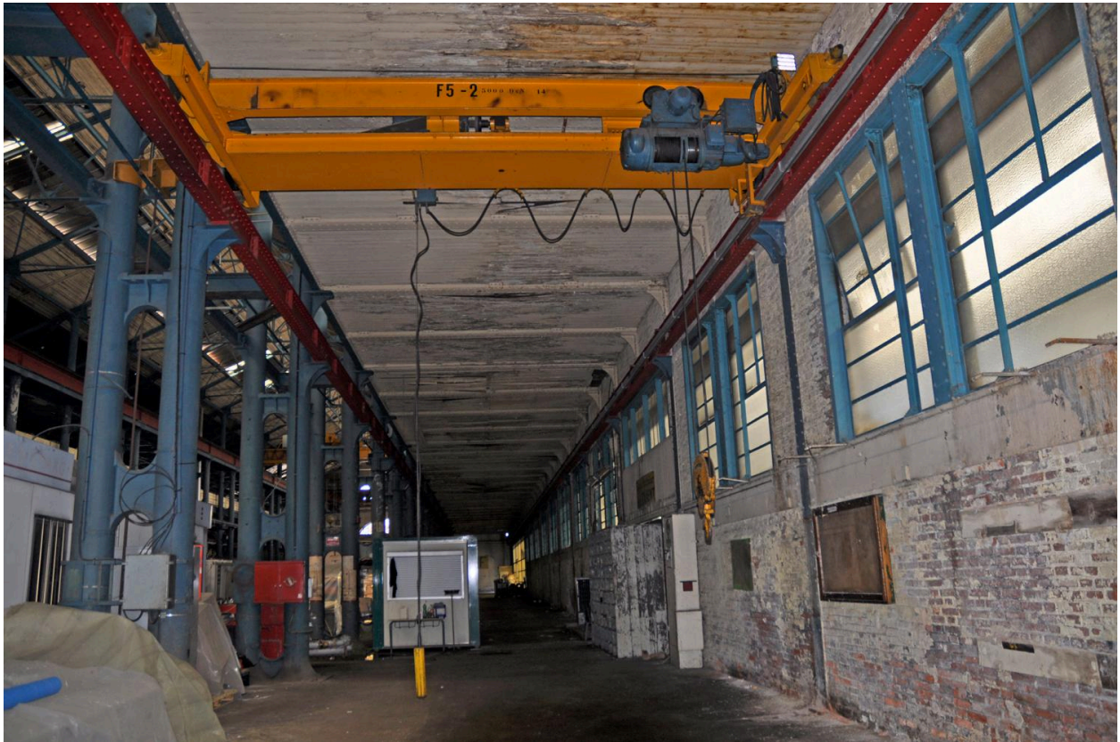
Pont roulant Halle 07
