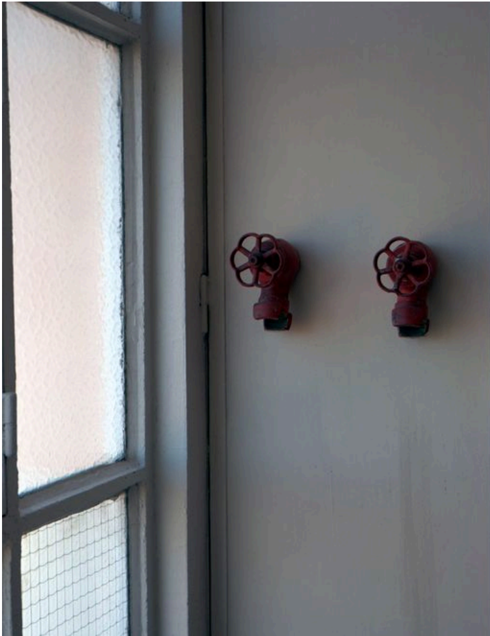
Prises de colonne sèche, repos de l'escalier
