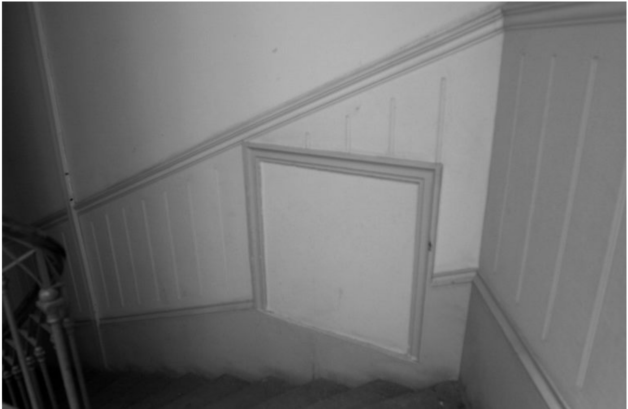
Cage d'escalier ouest : fenêtre de second jour condamnée
