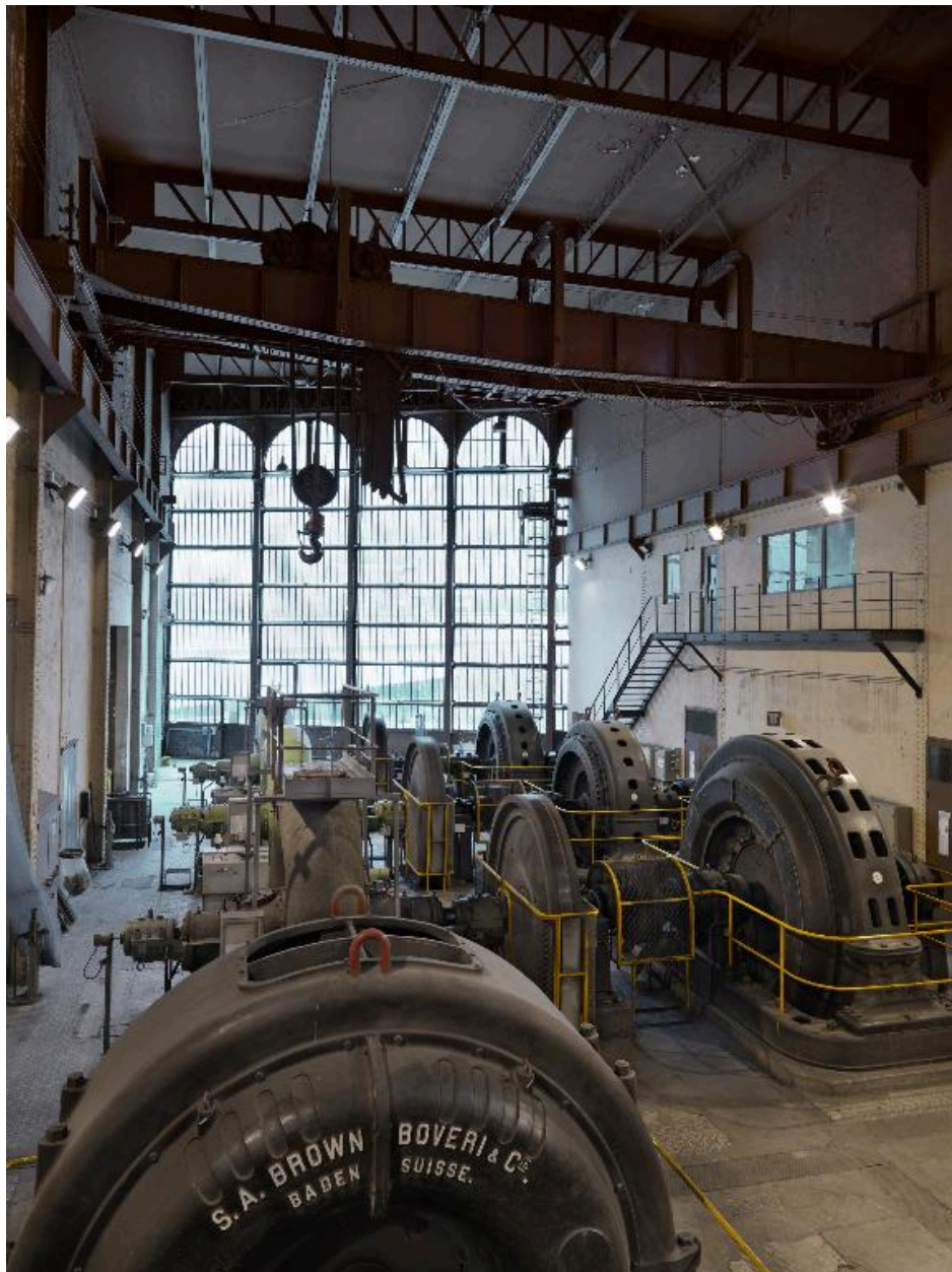
Vue de la salle des machines de la centrale de Livet II
