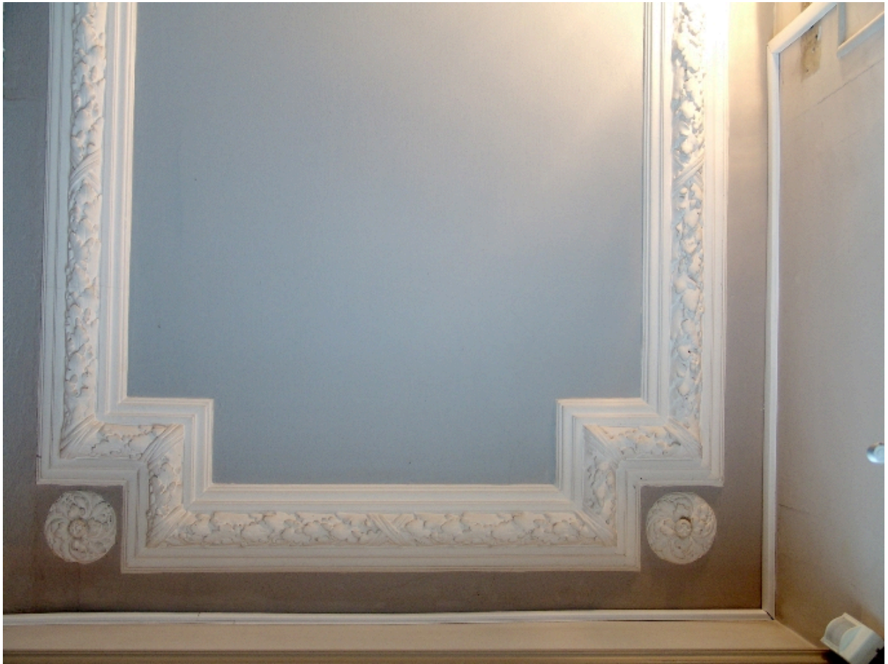
Plafond stucqué du palier
