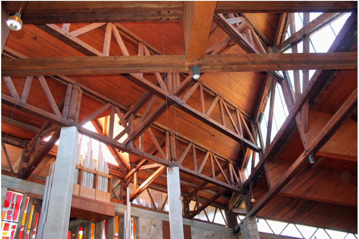
Brioude, chapelle de la Borie Darles, la charpente couvrant la nef, partie sud-est.
