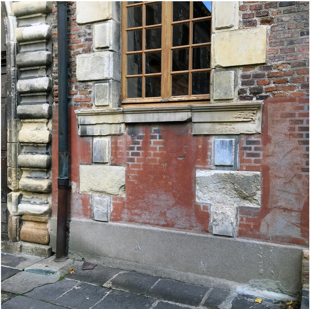
Corps de bâtiment principal, détail du soubassement avec reprises en ciment et faux appareil de brique peint
