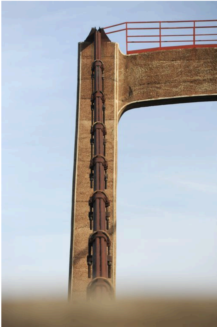
Pile droite, vue partielle : passage du câble au sommet (depuis la rive droite)
