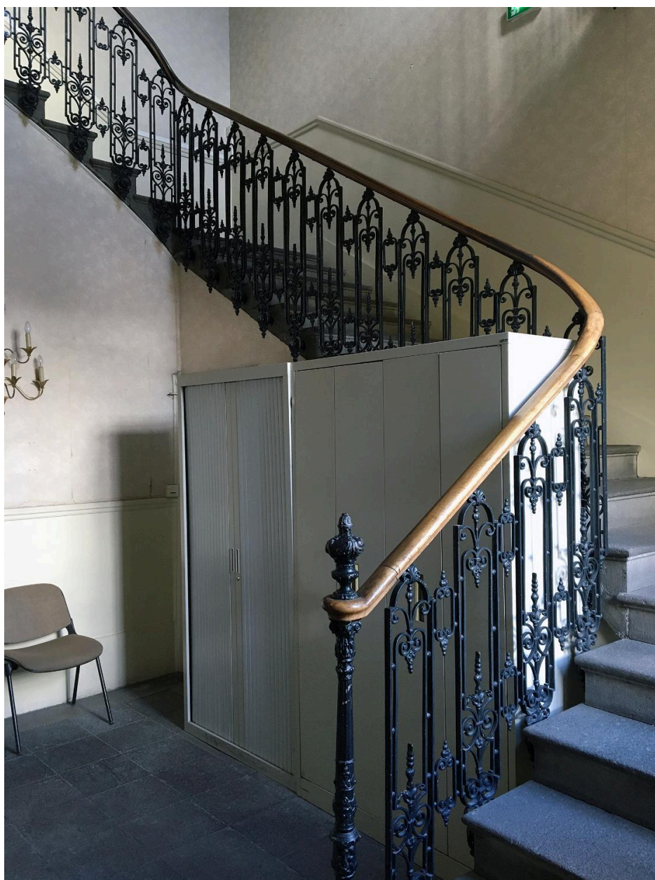
Corps de bâtiment principal : escalier desservant le bureau du président du tribunal
