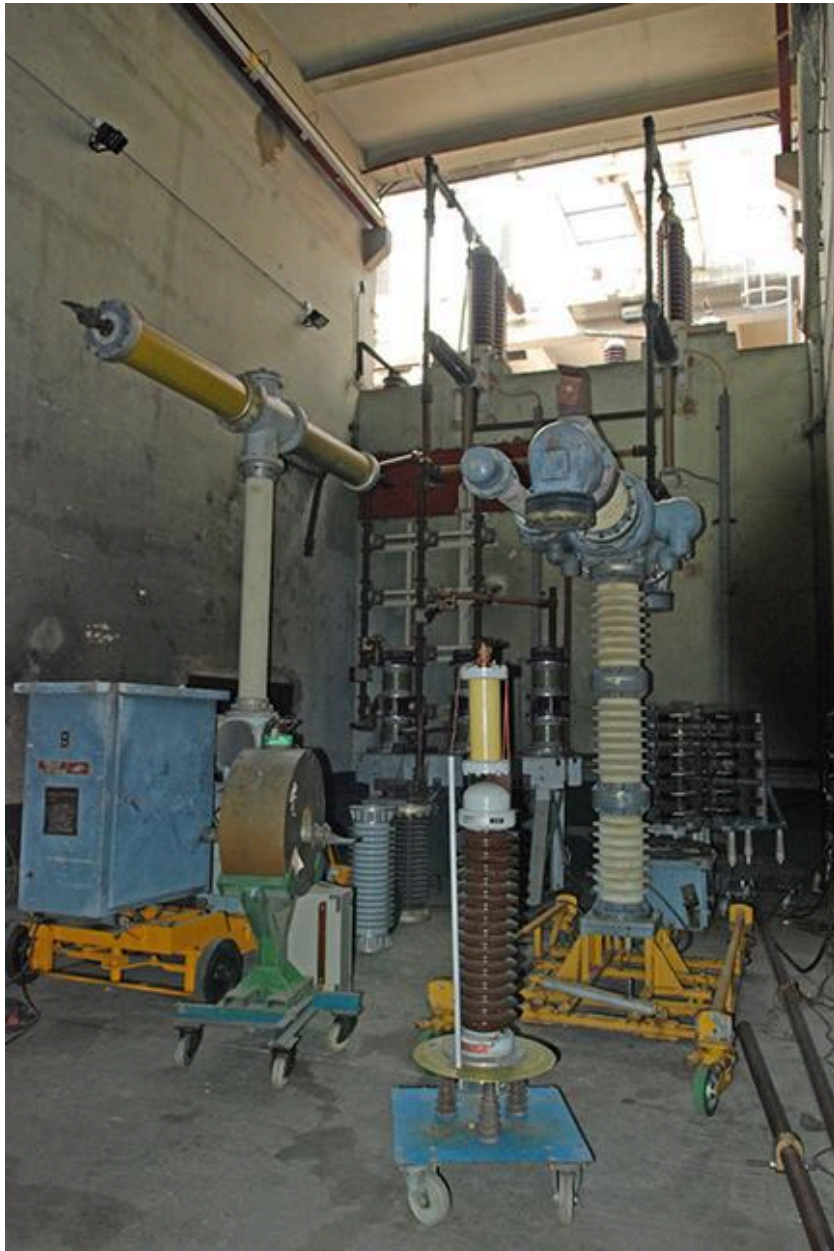
Vue intérieure des ateliers : disjoncteurs
