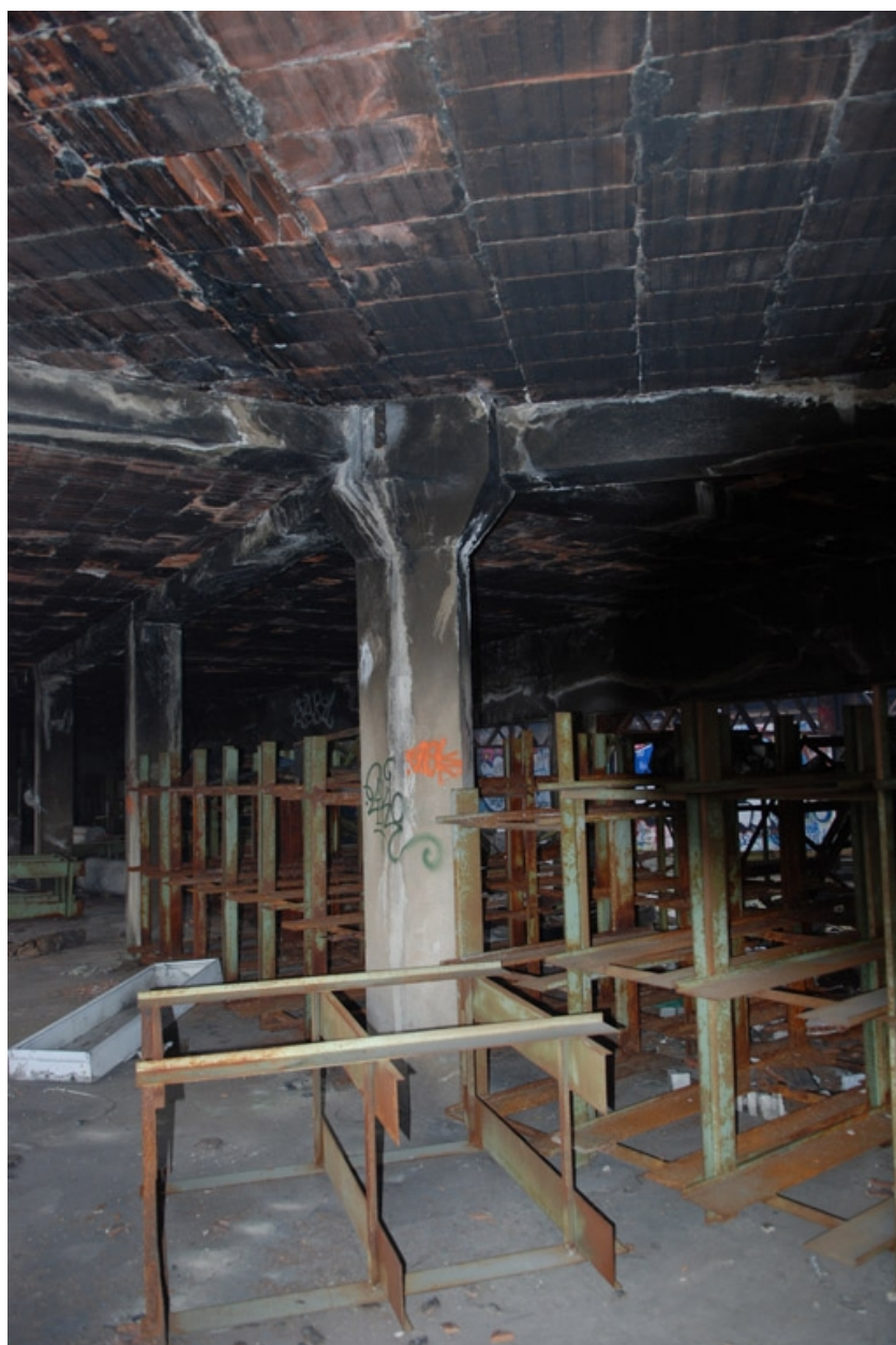
Stockage des chauffe-eaux : détail pilier eb béton central
