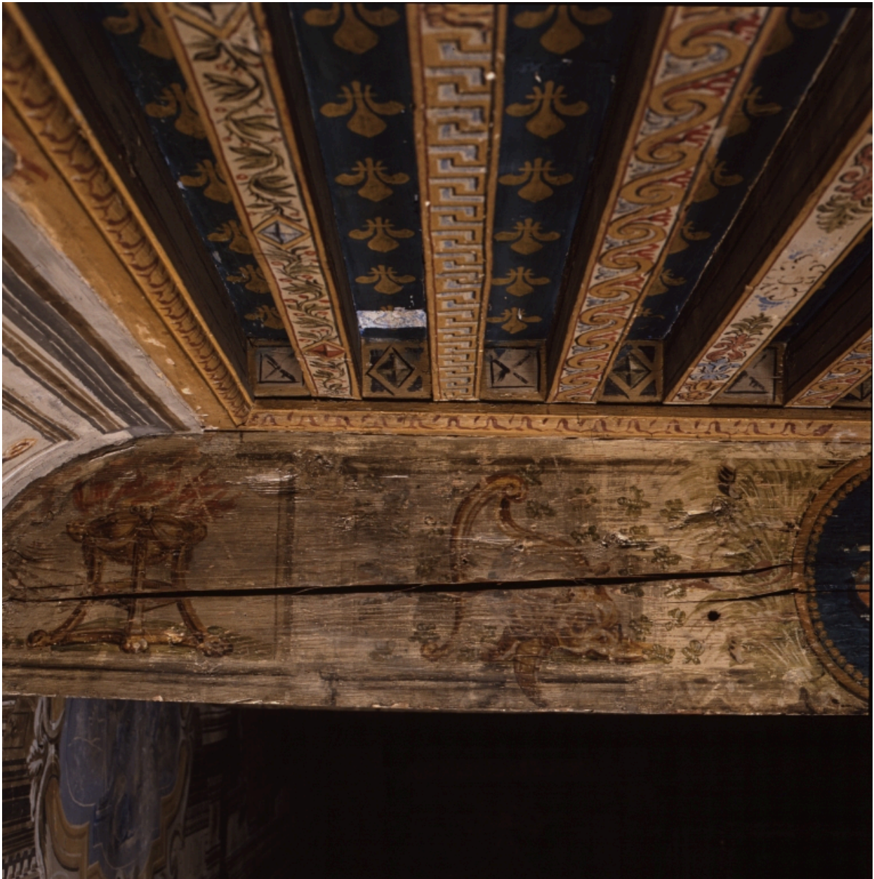
Poutre 4, face sud, extrémité gauche : des abeilles s'échappant d'un casque.
