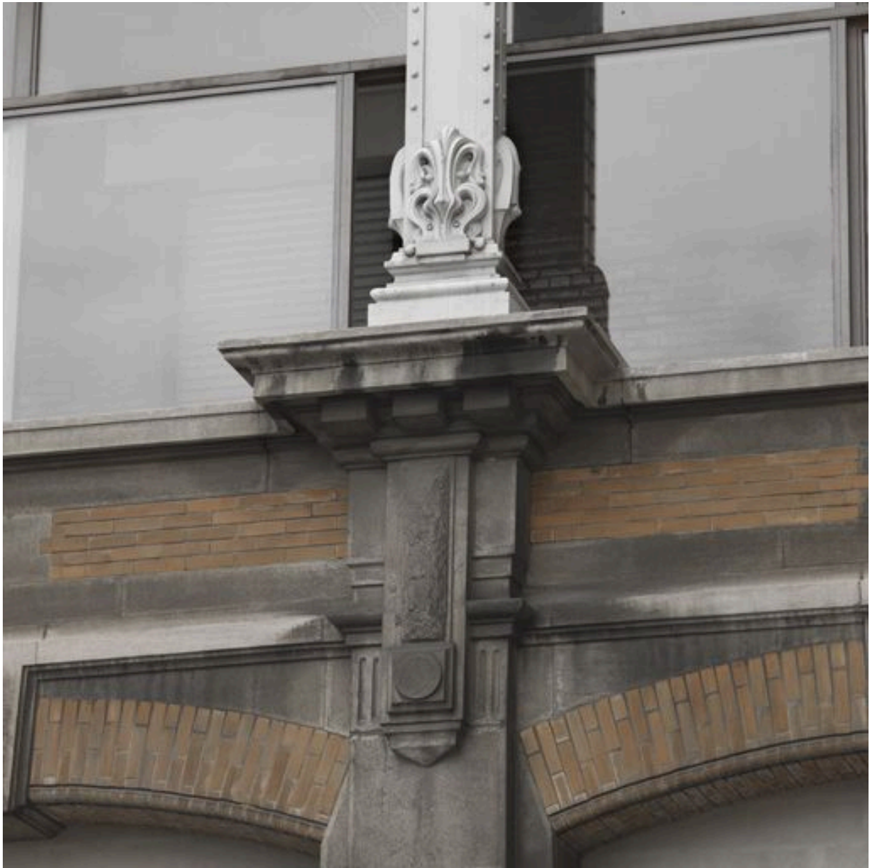
Bâtiment B, façade principale, galeries nord, base du cinquième poteau
