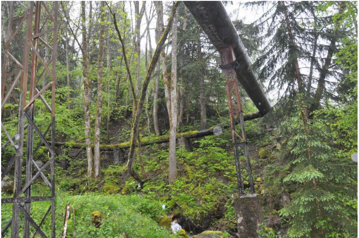
Jonction des conduites de la prise du nant de la Serraz et de celle du nant des fruitiers.
