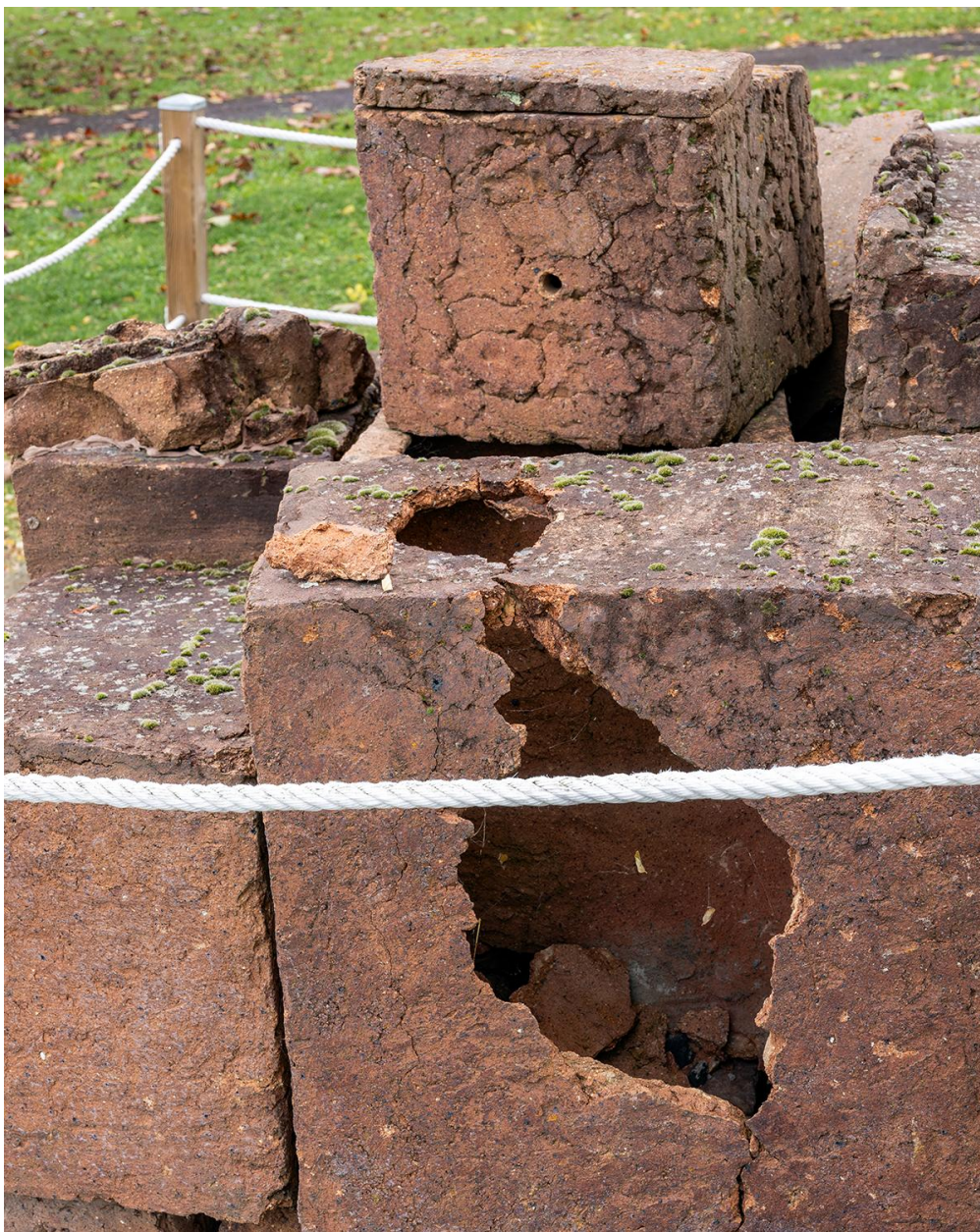
Détail d'un bloc cassé
