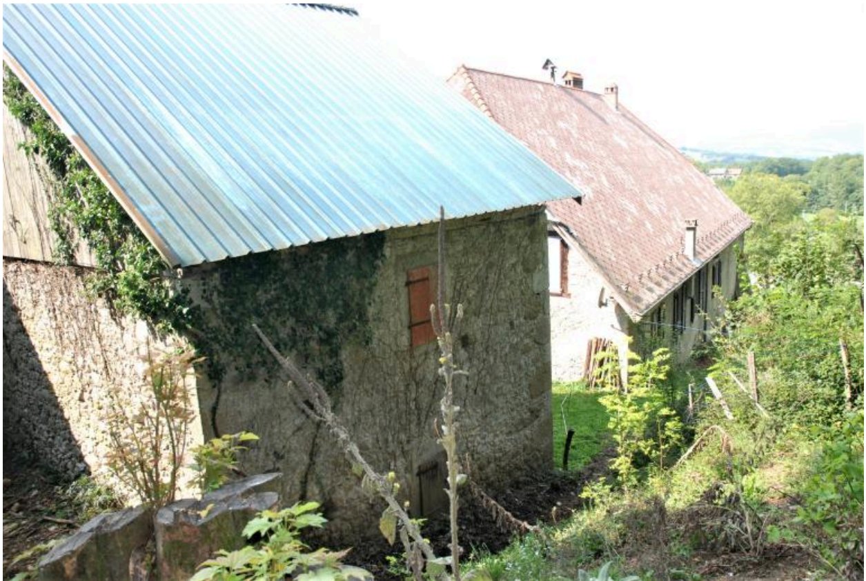
Vue d'ensemble des façades nord du Grenier et du corps de logis de la maison bourgeoise.
