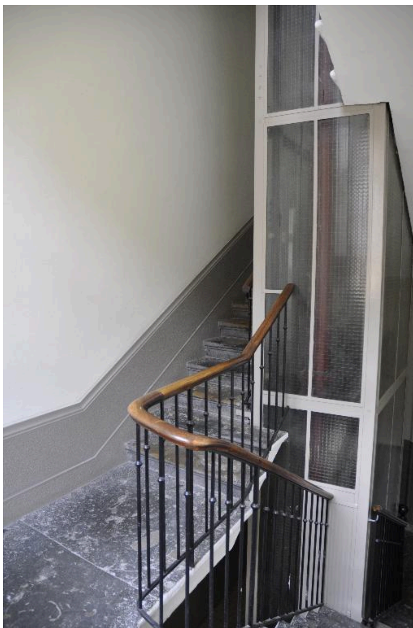
Vue de l'ascenseur insérer dans la cage d'escalier
