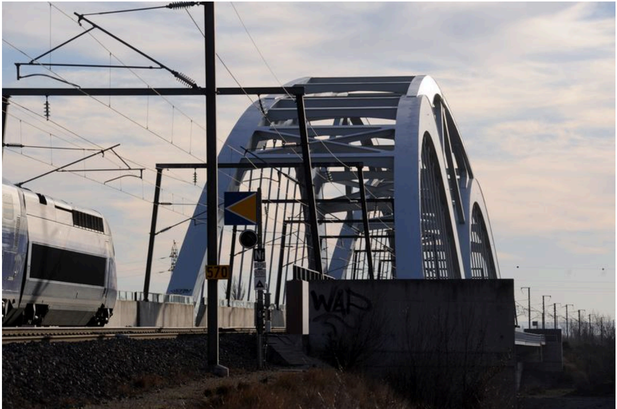
Vue partielle, de dessus, bow-strings et voie ferrée (depuis la rive gauche)
