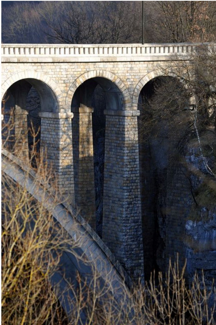
Partie gauche de l'arche centrale, face aval, vue de détail : ancrage à la rive (depuis la rive droite)
