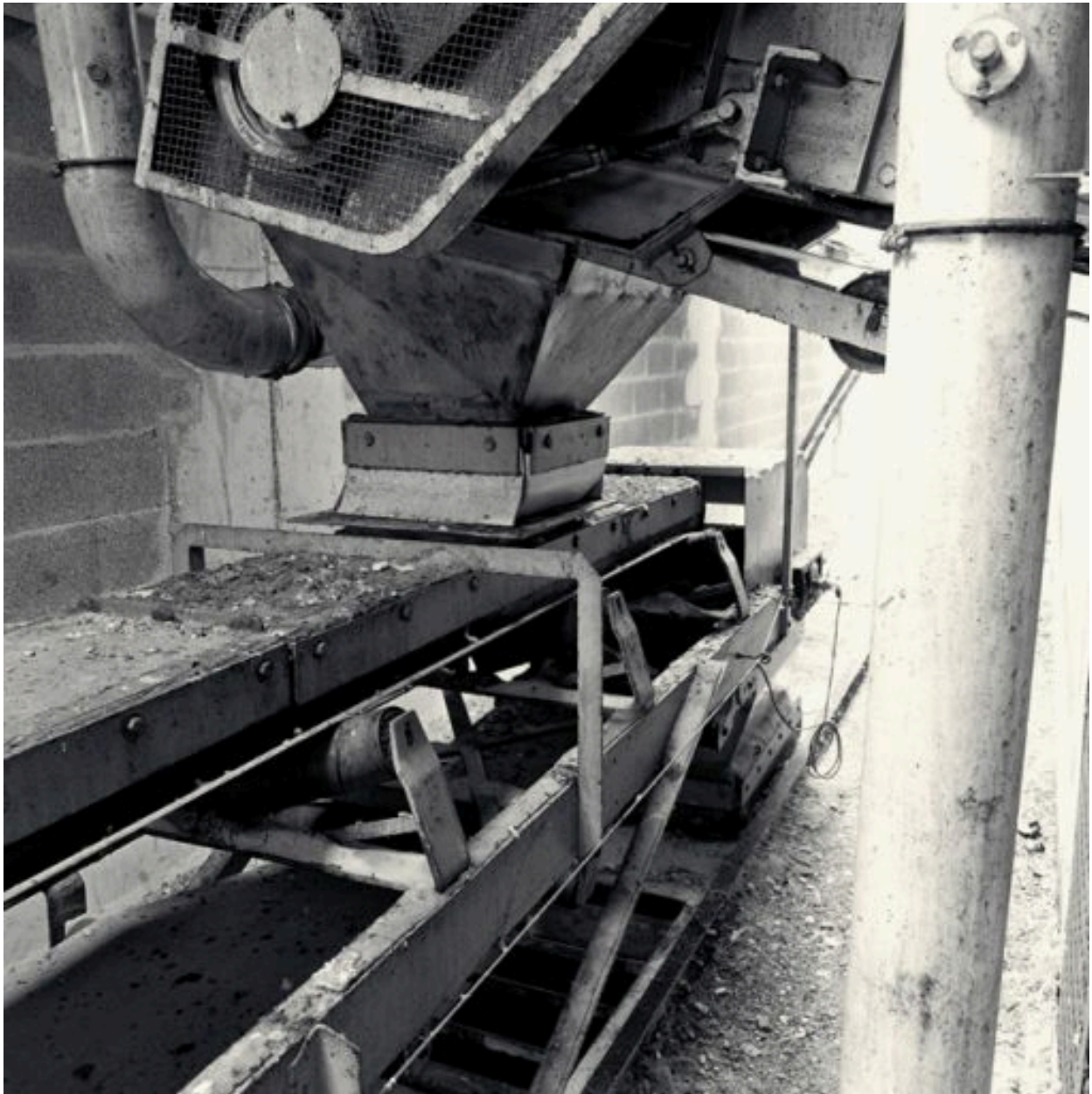
Intérieur des silos, la galerie supérieure : vue d'une trémie au-dessus du transporteur à bande
