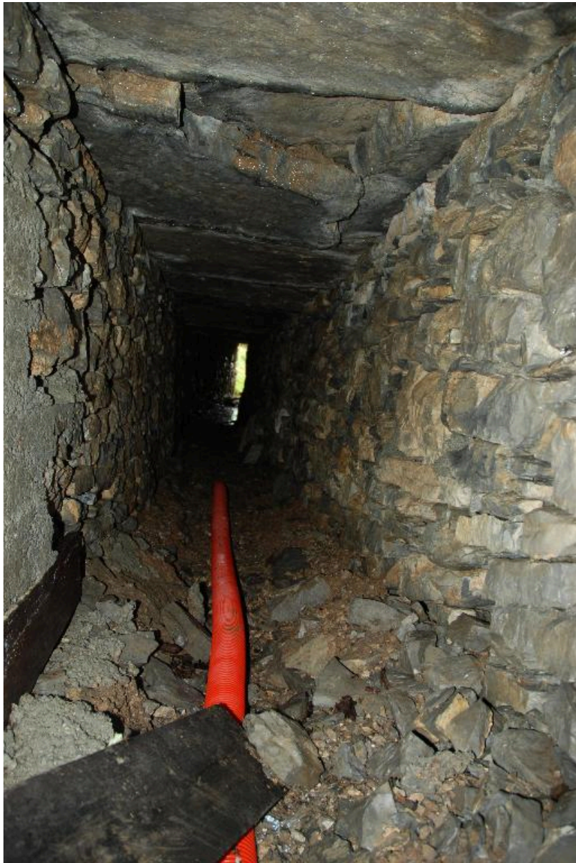
Prise d'eau aux Arbets (alpage de l'Arclusaz) : le couloir, vue en direction de l'entrée.
