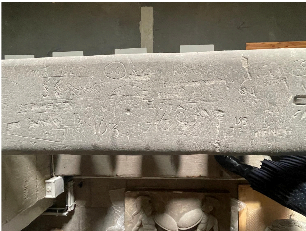
Tribunes : graffitis sur l'appui de la balustrade
