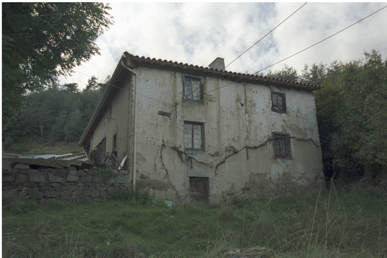
Cezay, la Chavanne (1987 A2 209), type A1. Vue d'ensemble de la façade principale du logis.
