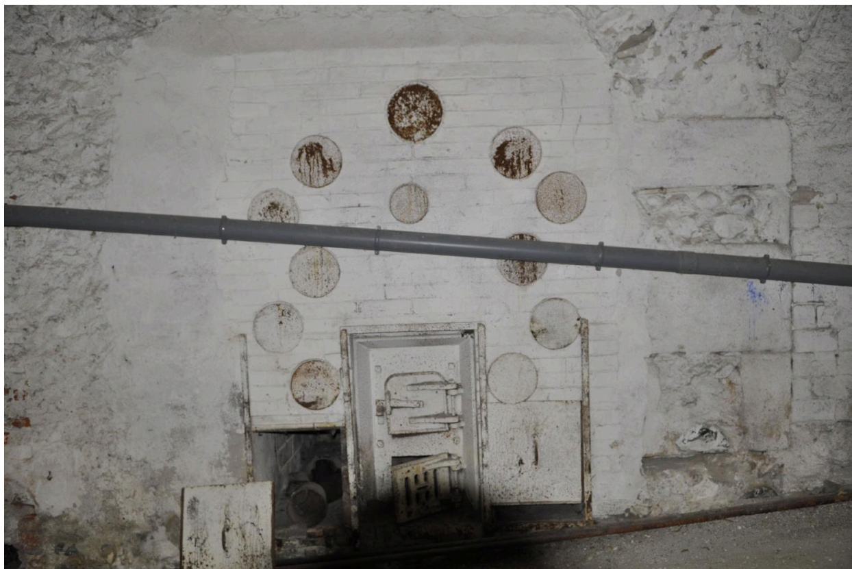
Chaudière de l'ancien système hydraulique
