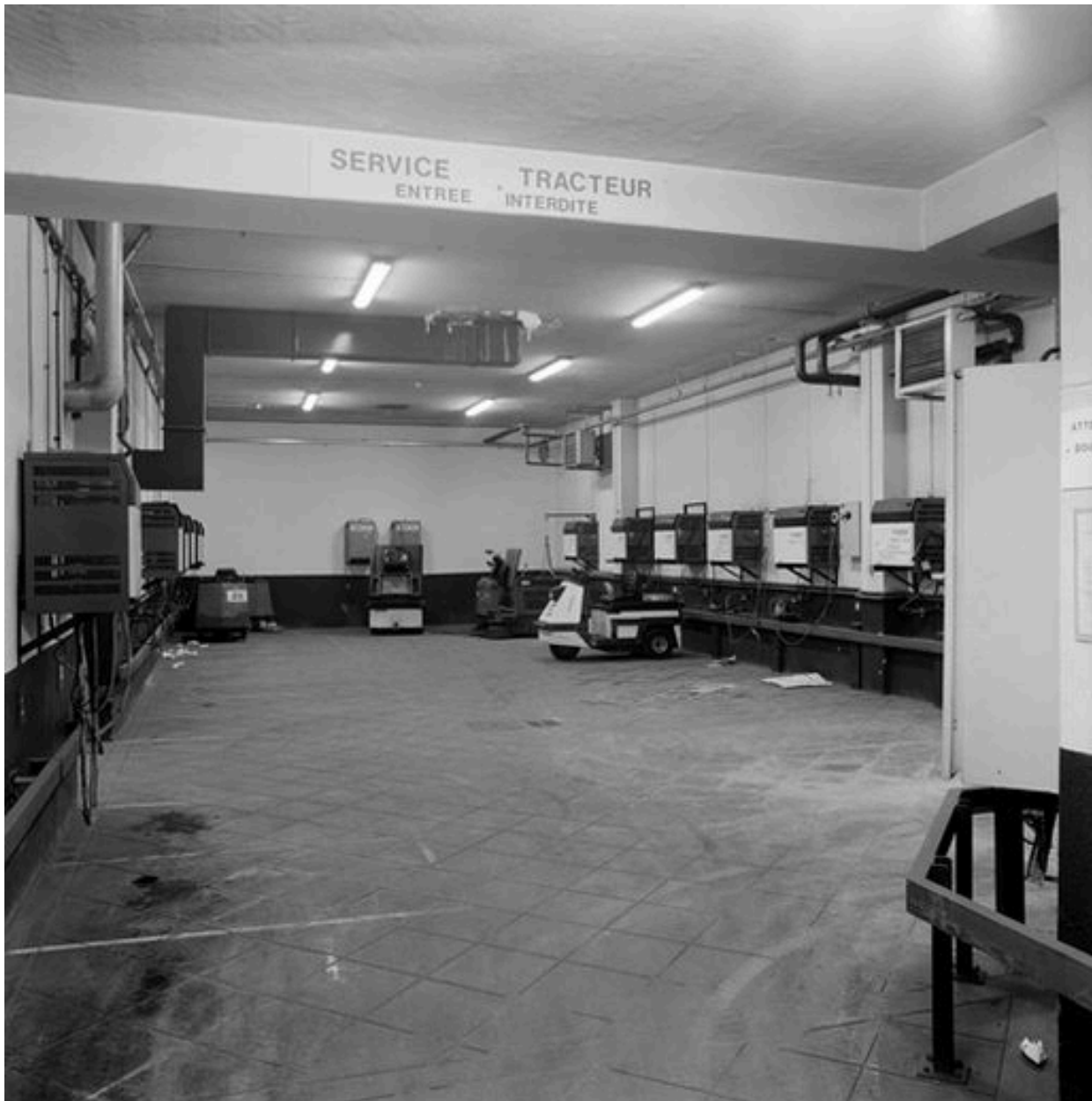
Le poste de chargement électrique des tracteurs au sous-sol du bâtiment 9
