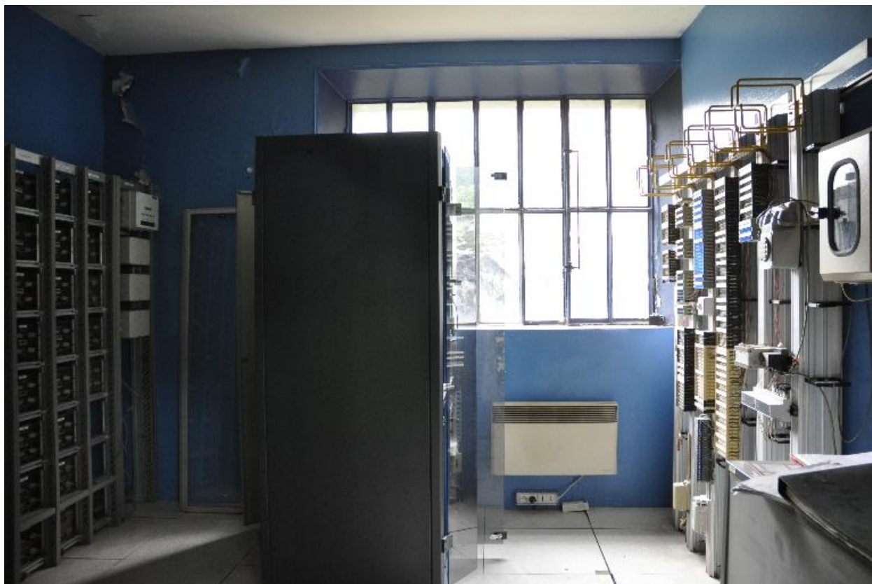
Vue de la salle des compteurs/ salle des telecoms
