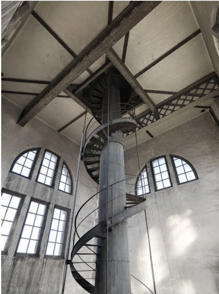
La dôme Pascalon. Le haut de l'escalier métallique et le plafond du 1er étage
