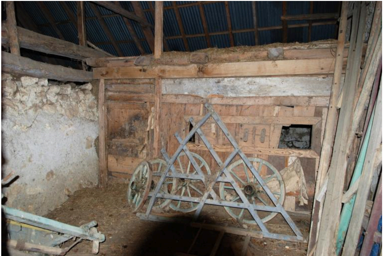
Vue intérieure de l'espace grange avec cloison de séparation avec l'étable (porte à gauche)
