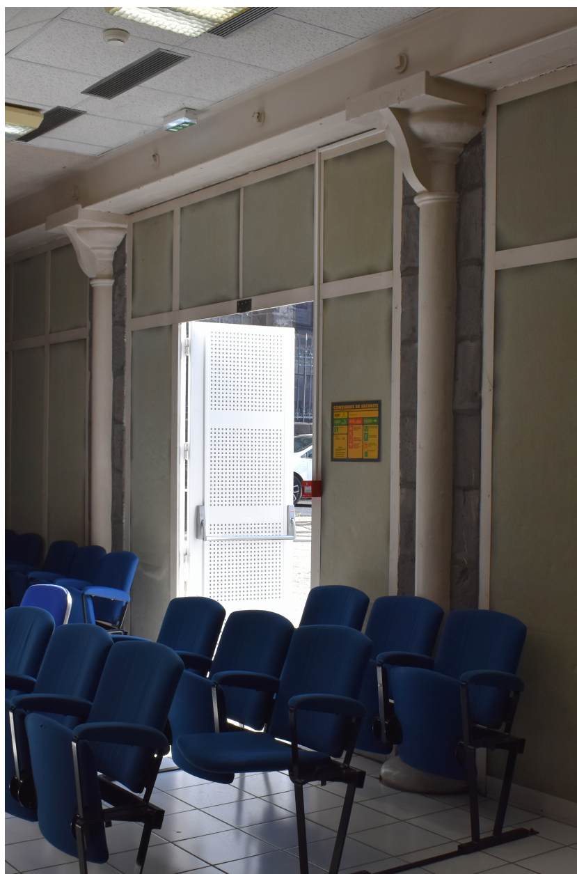
Bâtiment D, étage de soubassement : colonnes en fonte au revers de la porte d'entrée de l'auditorium
