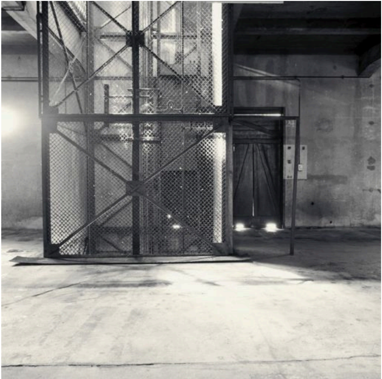
Intérieur du bâtiment de 1927 (bâtiment sud) : le monte-charge, vue de face (2e étage)
