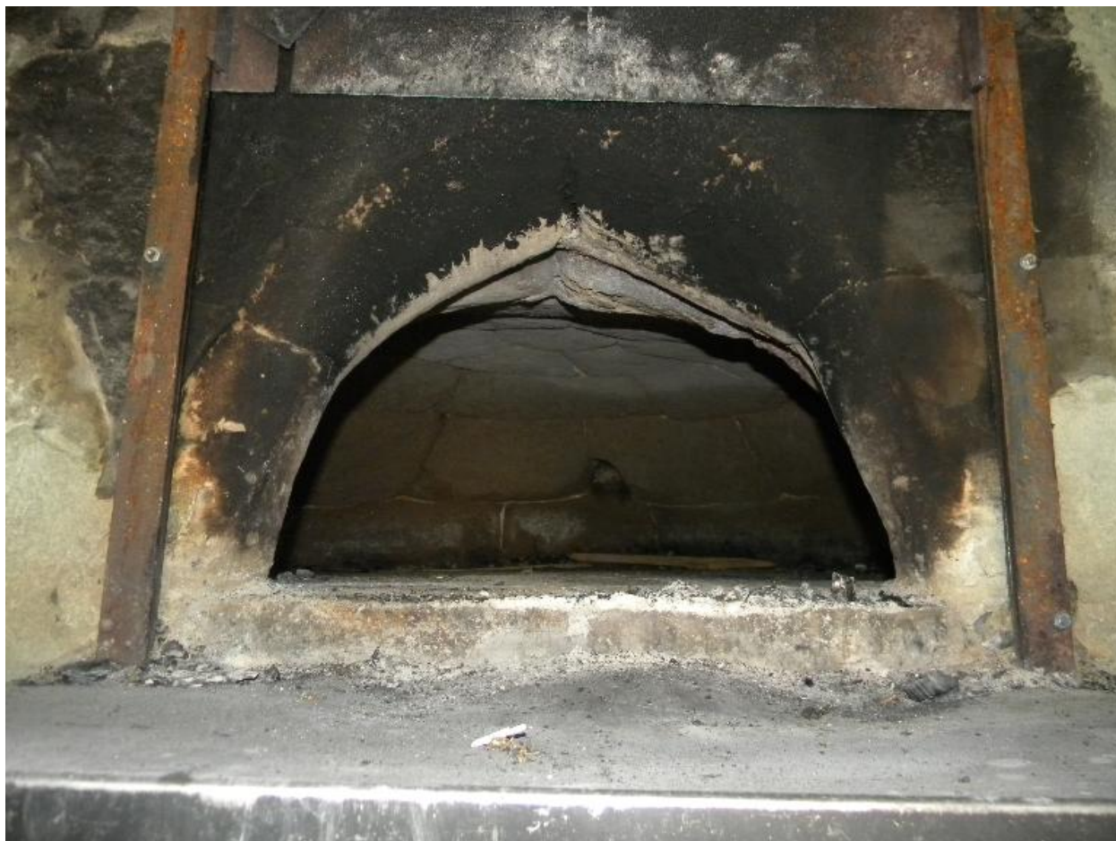
Vue de la bouche du four.
