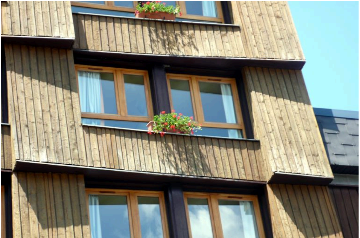
Détail de la structure de la façade et de l'essentage de planches
