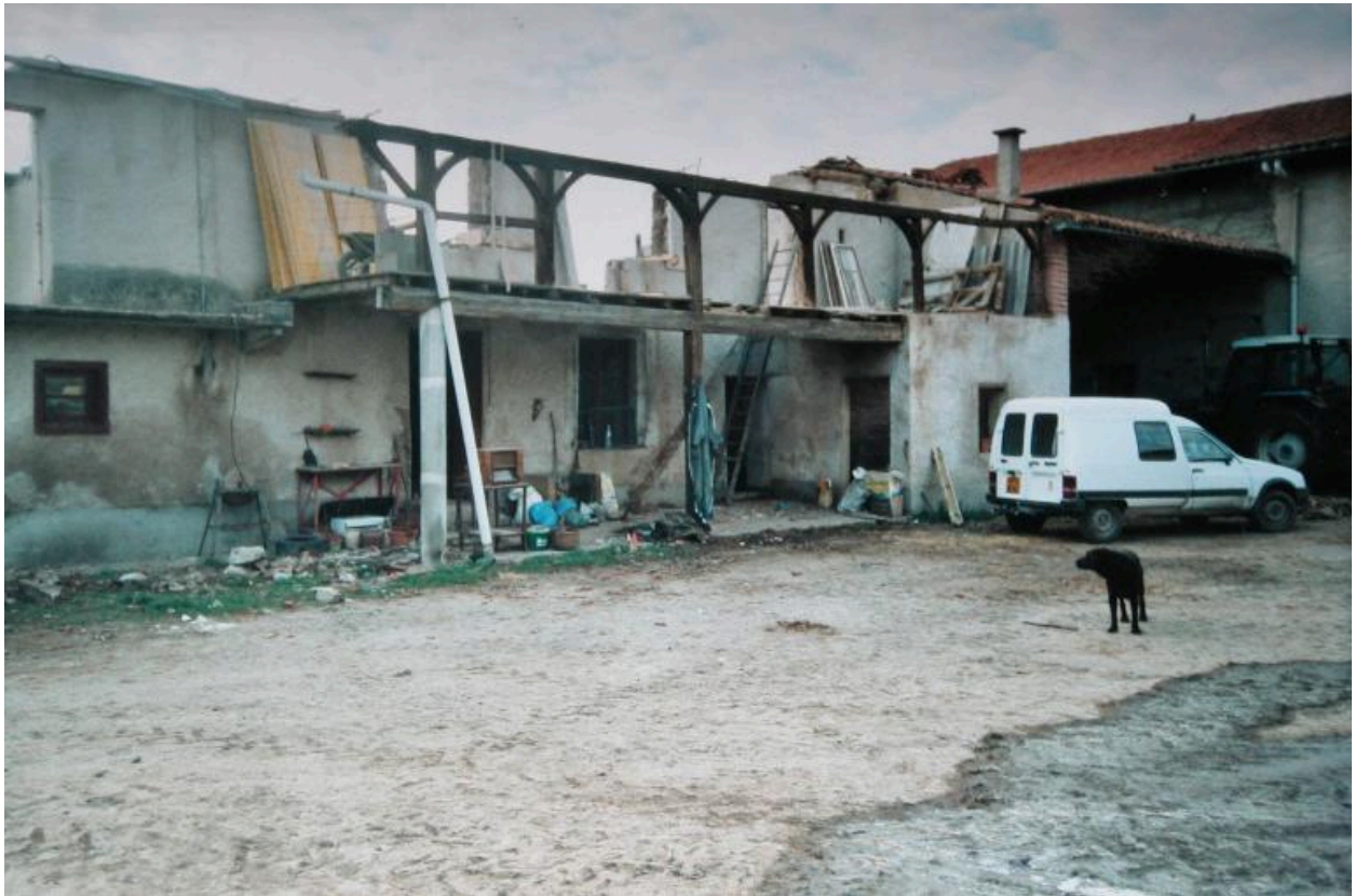
Photo ancienne du bâtiment ancien après destruction partielle
