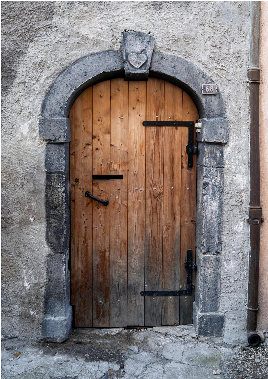
Encadrement de porte en arc sur imposte avec un coeur sur le claveau. (2008 D15 5368).
