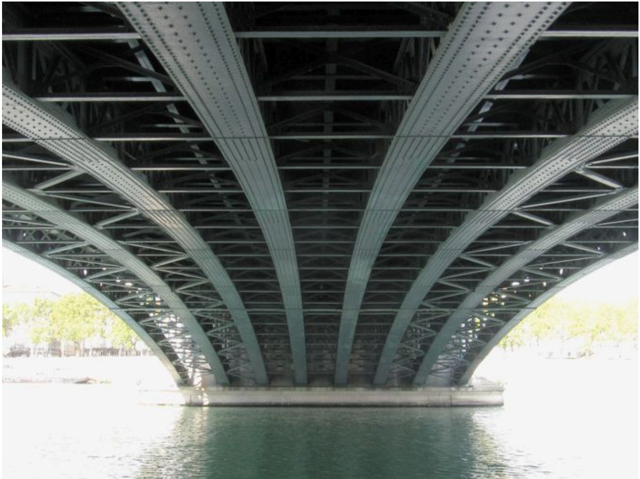
Vue partielle, de dessous, structure de l'arche et pile (depuis la rive gauche)
