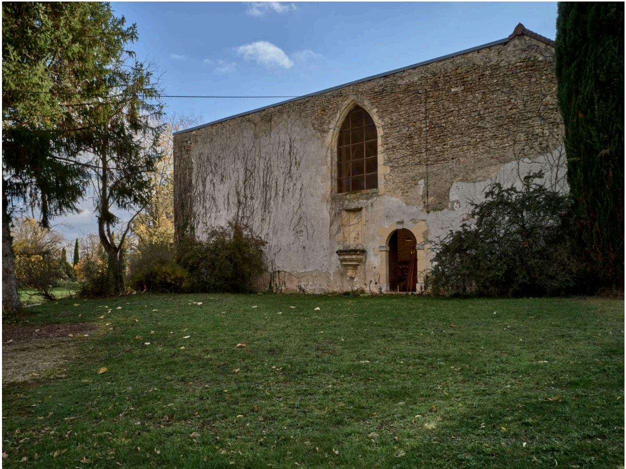
Mur gouttereau méridional subsistant de l'église détruite, sur sa face intérieure.
