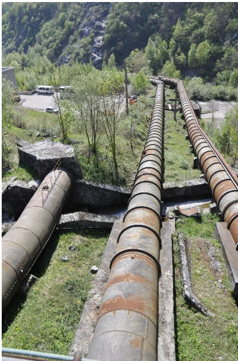
Vue des conduites forcées
