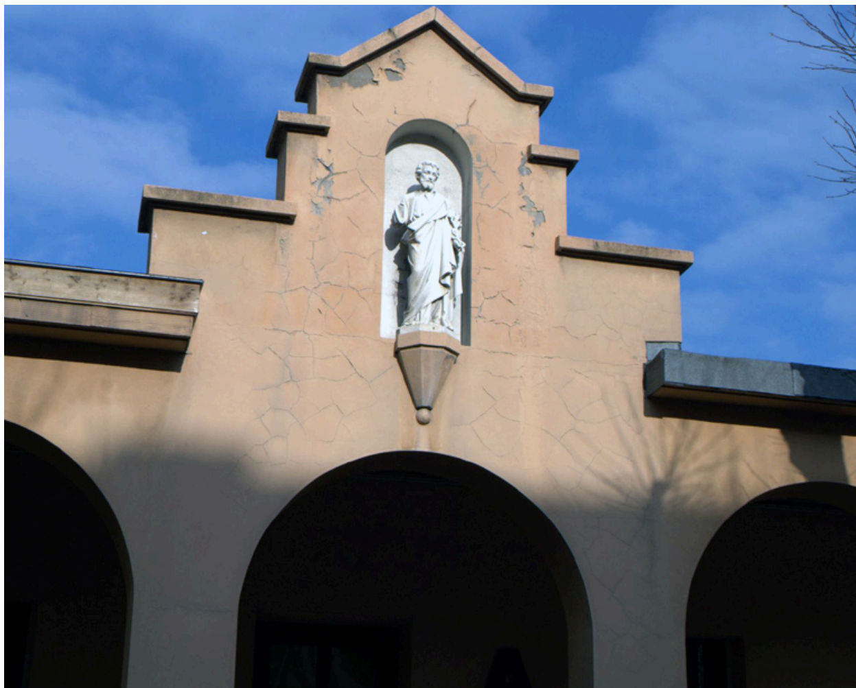
Bâtiment d'entrée, détail de la niche portant la statue de saint Joseph
