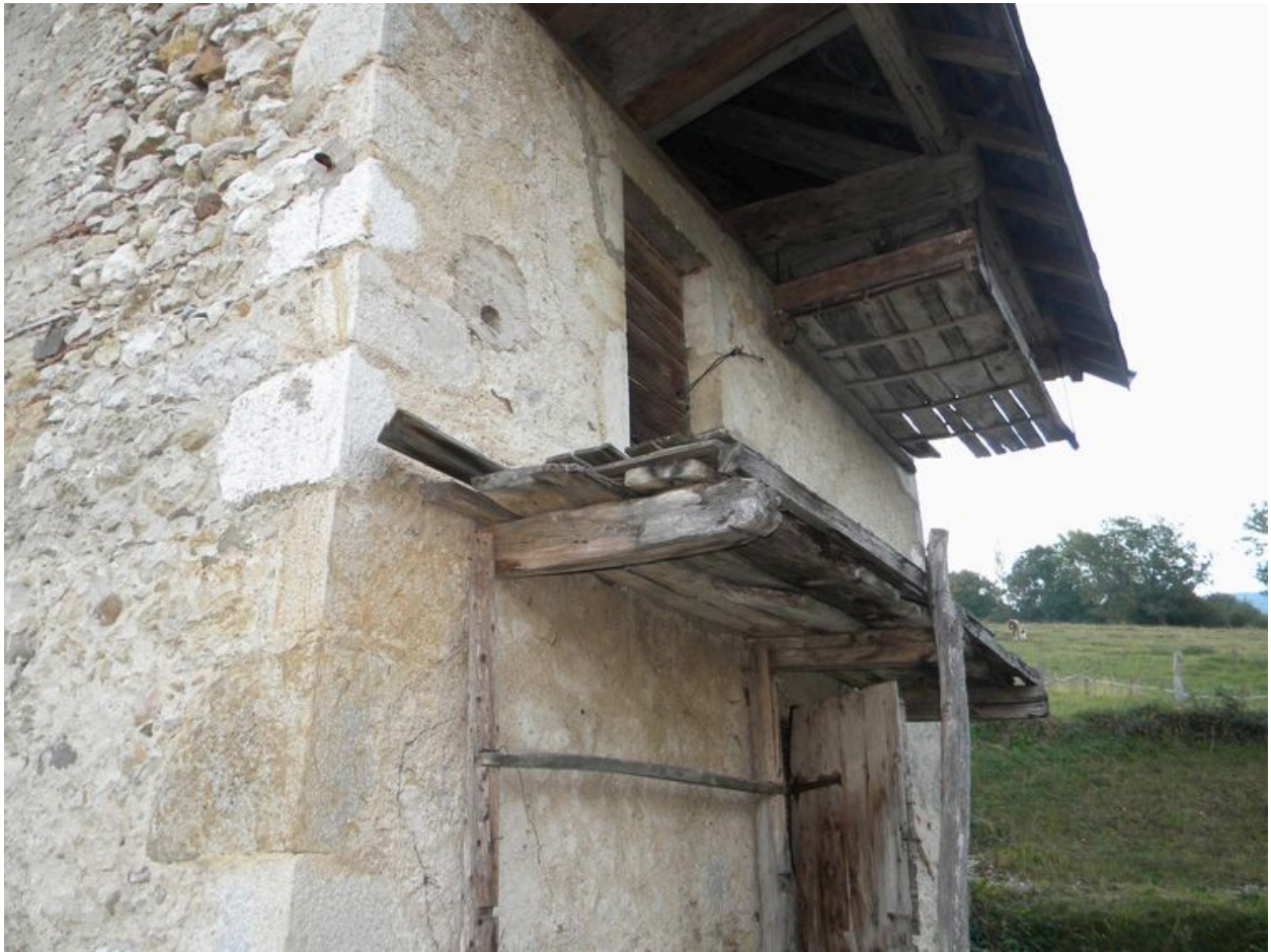
Vue de la façade sud-ouest avec le débord de toit et la suspenne de séchage.
