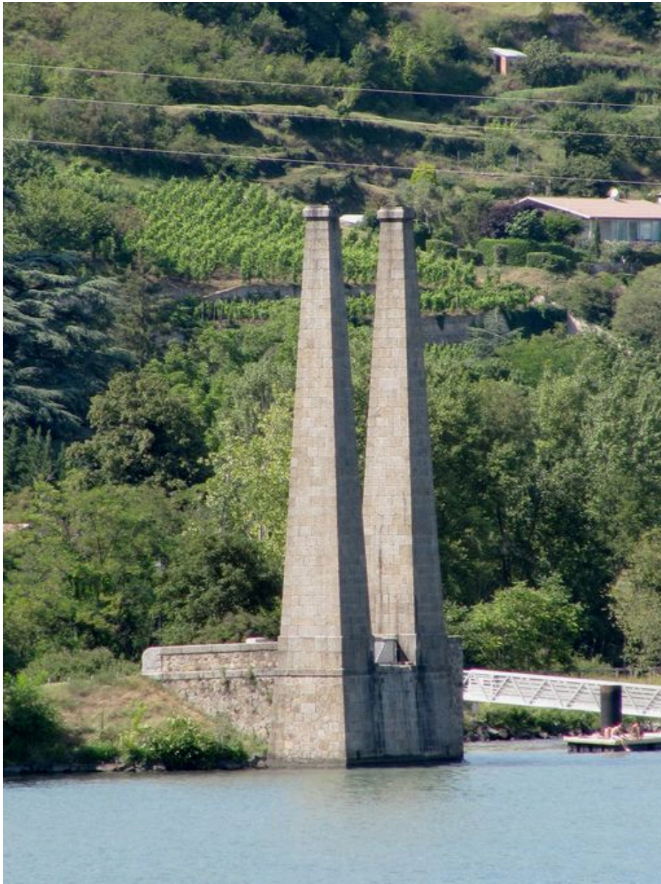
Vestiges de la pile-culée de la rive droite (depuis le pont de Chavanay)
