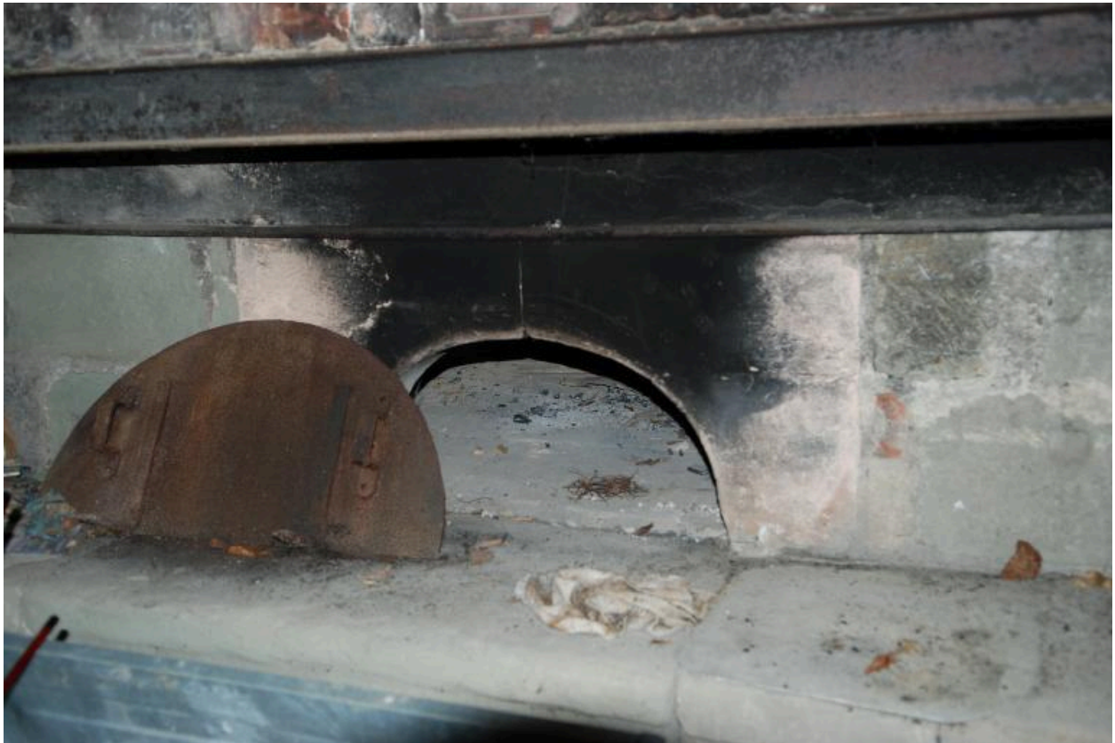
Détail de la bouche du four.
