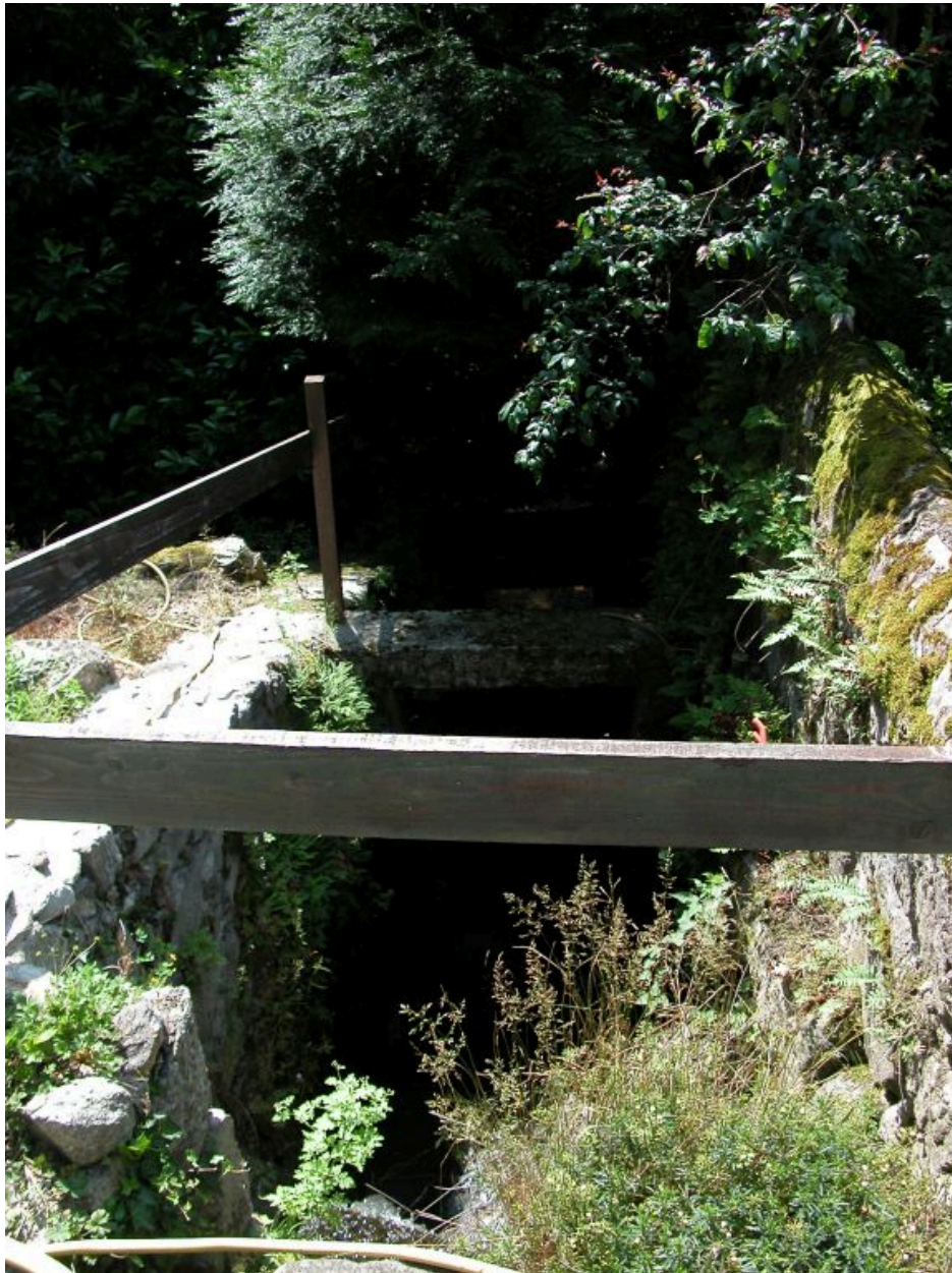
Détail de la chute d'eau au revers de la vanne de régulation du trop plein.
