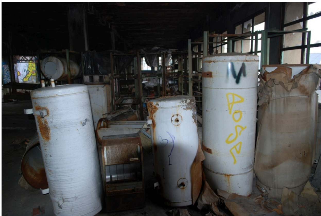
Vue d'ensemble du stockage des chauffe-eaux
