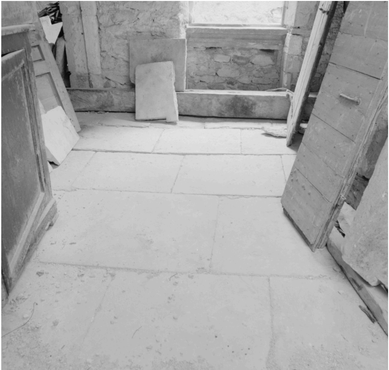
1er étage, pièce donnant sur la rue ds Fontaines, détail du dallage.
